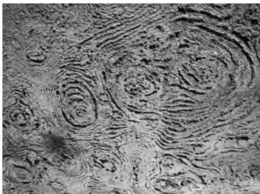
Abb. 50: Auswitterungen im Deckenputz des Gruftraumes 1
